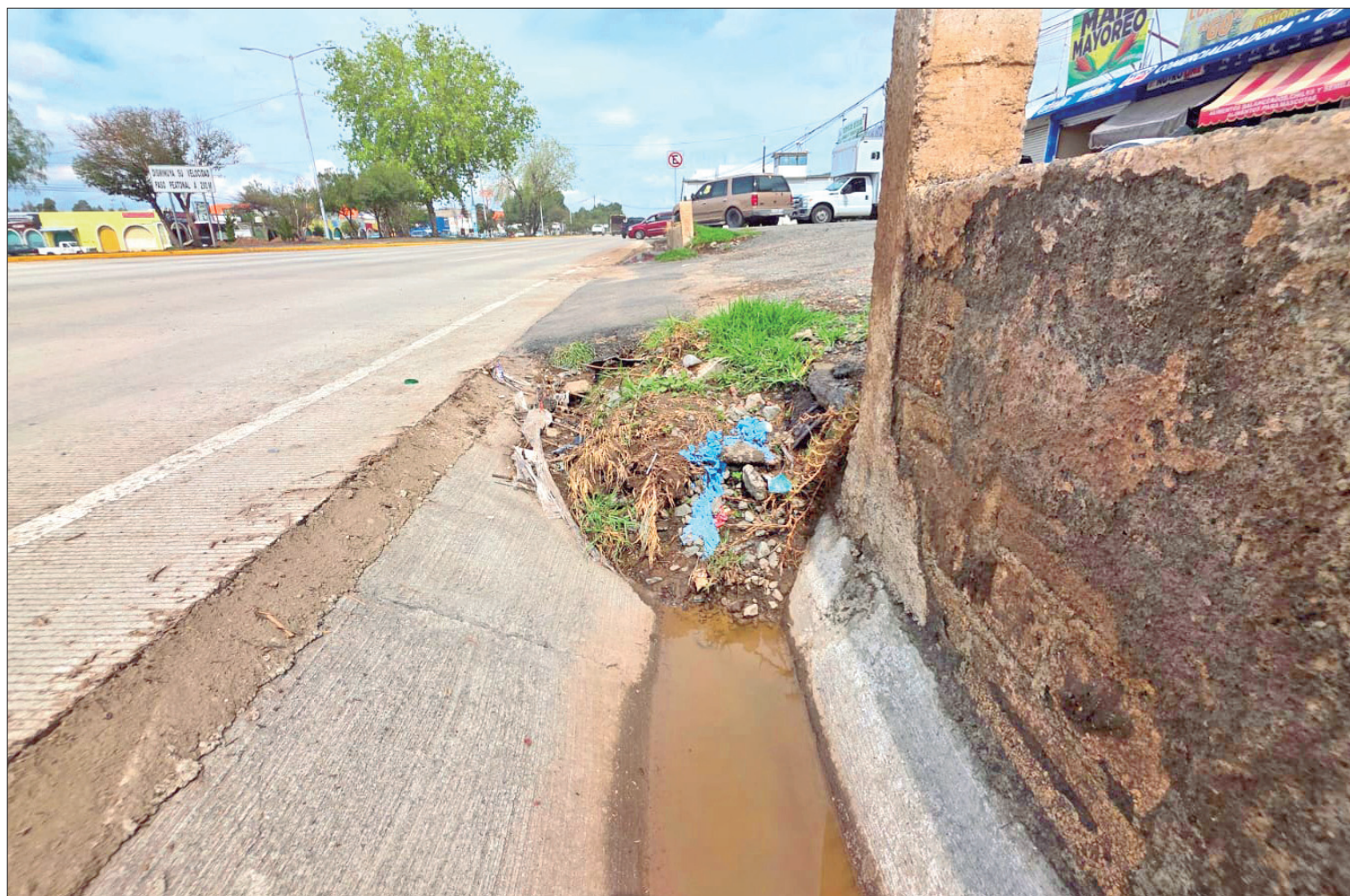
EJEMPLO. Presidente municipal de la Bella Airosa, Jorge Alberto Reyes, manifestó que parte de las afectaciones que se tuvieron en el fraccionamiento Progreso, en el que más de 30 viviendas resultaron afectadas por las inundaciones, pudo haber sido causa de la contaminación en la que se encuentra el canal.
