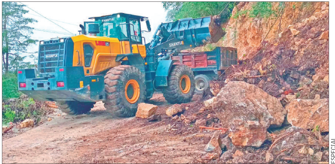
SIGNOS. Resaltó el secretario de Infraestructura Pública y Desarrollo Urbano Sostenible que mantienen una comunicación permanente con las distintas residencias regionales para atender cualquier incidencia que se presente en las carreteras estatales y caminos vecinales.
