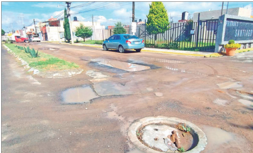
RECURRENCIA. Al encontrarse en pésimo estado las calles, se han vuelto intransitables y dificultan el acceso tanto a esta como a otras privadas cercanas.
