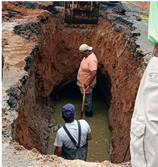
Socavón en Santa Martha.
