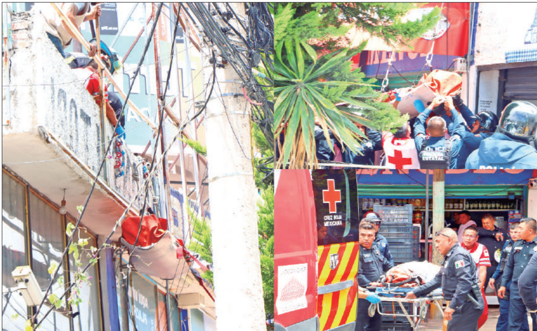
ELECTRICIDAD. Un sujeto resultó lesionado al recibir una descarga eléctrica, cuando realizaba labores de mantenimiento en la azotea de un establecimiento, ubicado en el bulevar Felipe Ángeles, en Pachuca.
