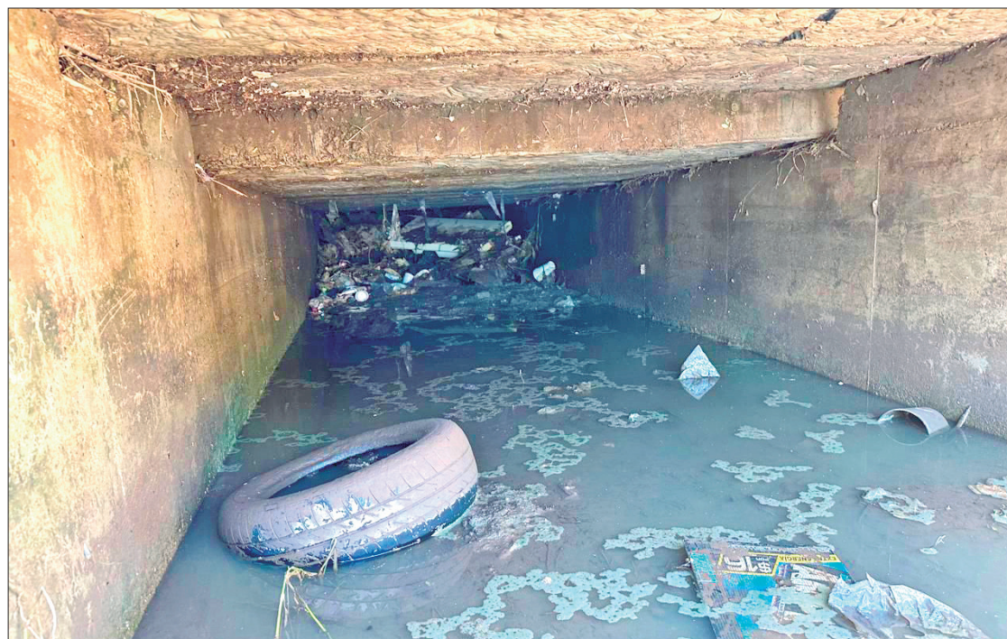
LA REFORMA. Situación contribuye directamente a la generación de encharcamientos e inundaciones.
