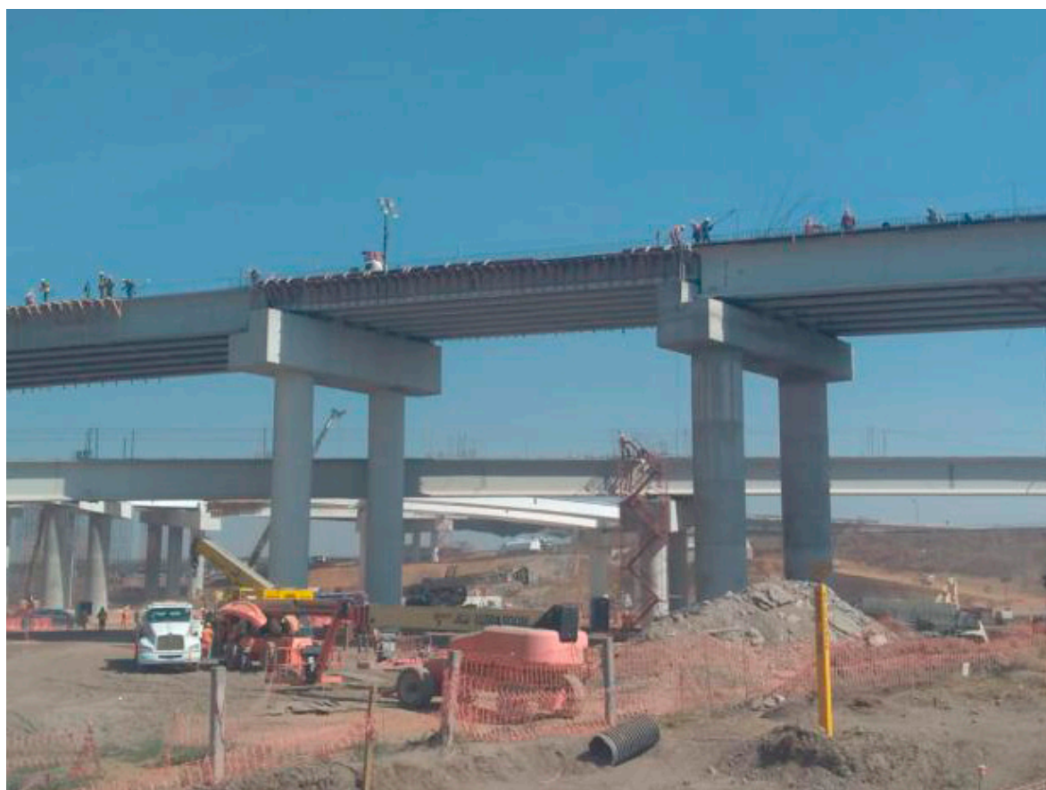
Segmentos sin concluir en el último tramo de la ampliación del CEM son notorios.
