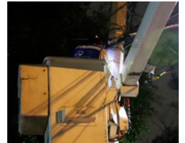
Senderos de diversas colonias en la Álvaro Obregón ya cuentan con iluminación.
