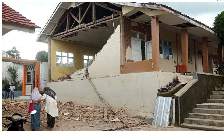
Edificio destruido en Cianjur, epicentro del terremoto, y localidad a tan solo 75 kilómetros de Yakarta.
