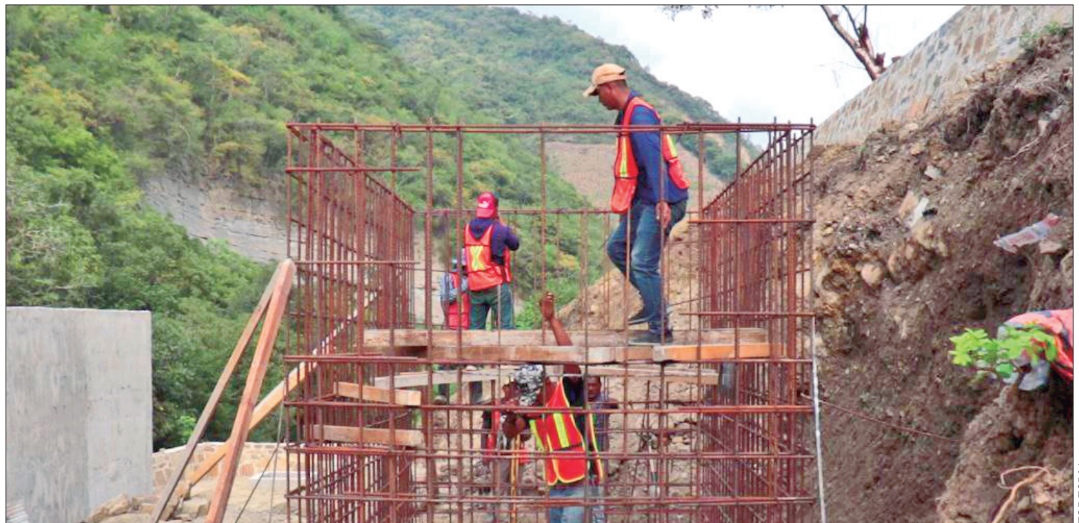
RECURSOS. La planta de tratamiento tiene un monto de inversión contratada de 1 millón 920 mil 731.40 pesos.
