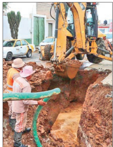
CAMBIO. La tubería contaba con aproximadamente 25 años de antigüedad y ya había logrado cumplir con su vida útil.
