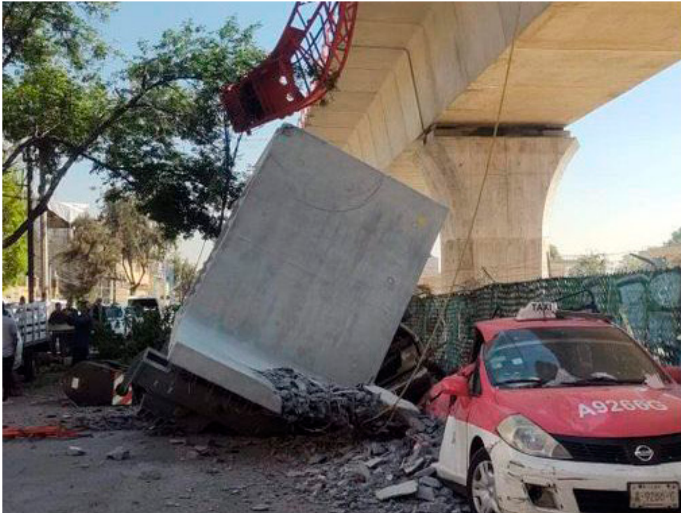
Dos vehículos fueron aplastados por el concreto.
