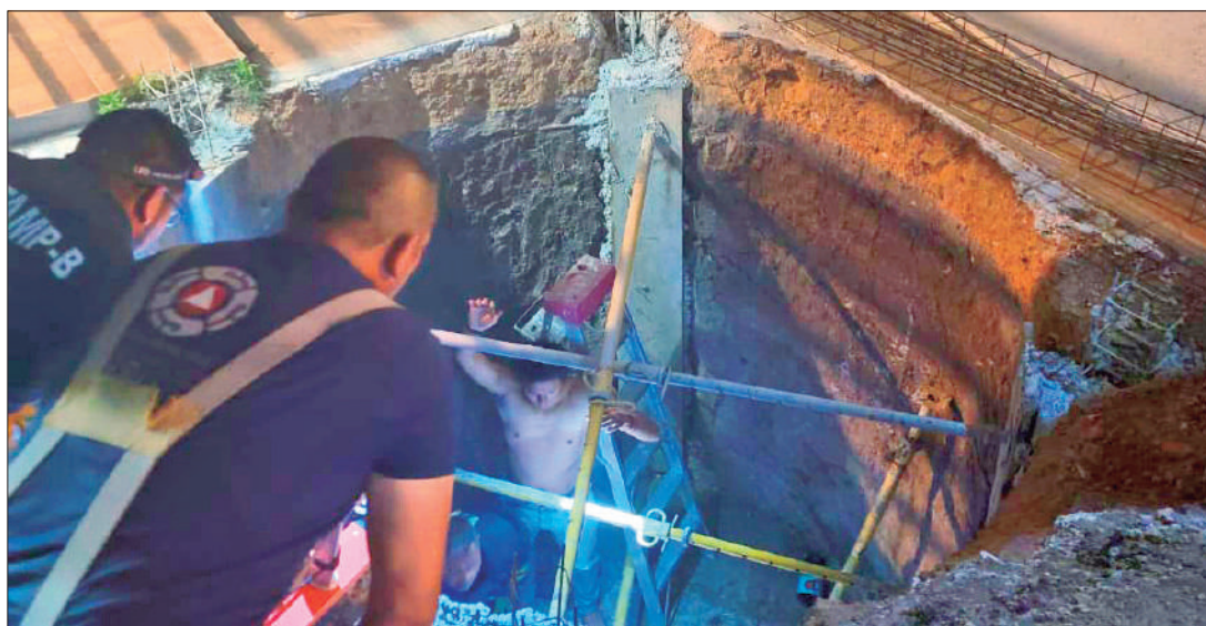
Elementos de Bomberos del Estado y de Protección Civil de Pachuca rescataron a un sujeto que había caído a una cisterna en construcción.
