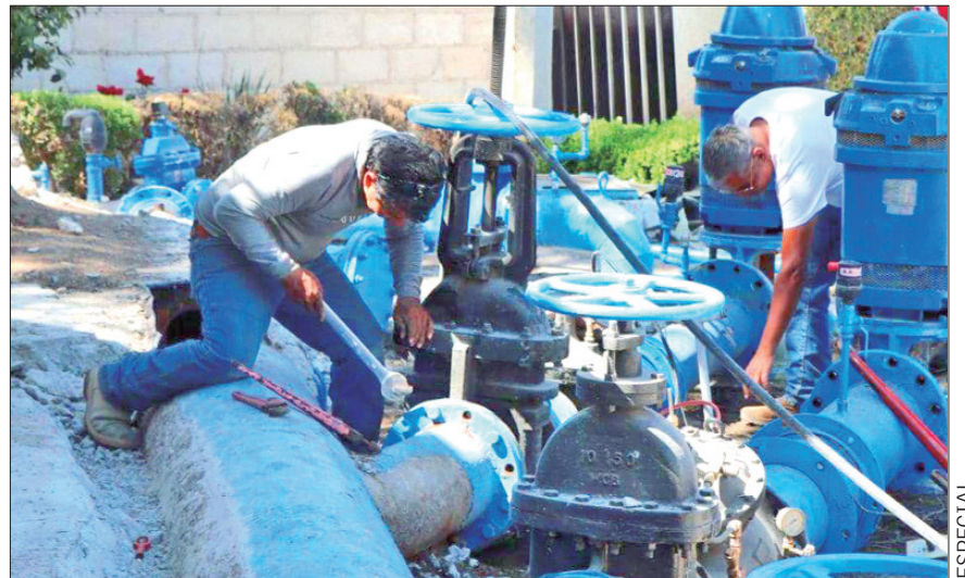
HECHOS. Las variaciones de voltaje que se presentaron, generaron afectaciones en 10 pozos.
